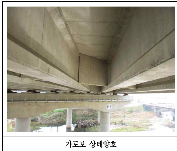
【사진 9.3.7】 가로보 손상현황
