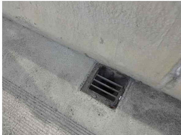
S4 그레이팅 파손
