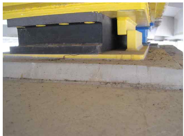
P4-Sh2 무수축물탈 균열(0.2mm/0.1m)
