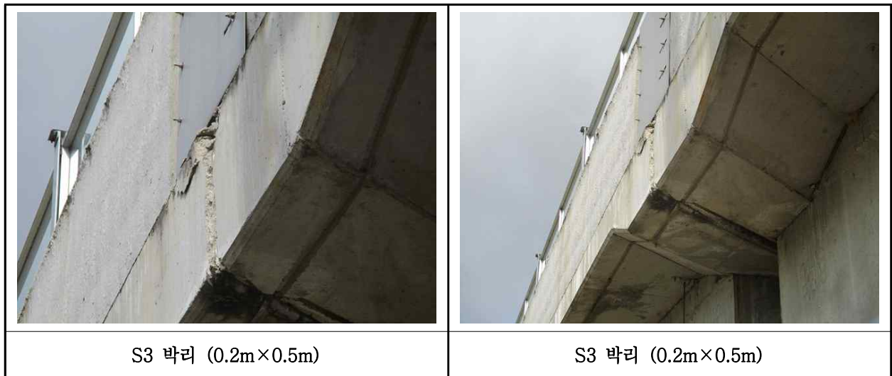
【사진 9.3.3】 바닥판하면 손상현황
