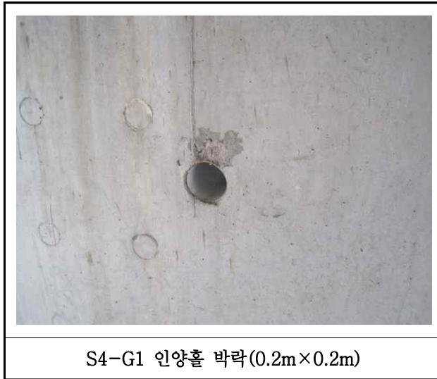
【사진 9.3.5】 거더 손상현황
